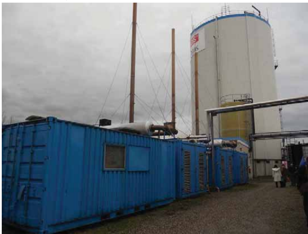
図 35 発電プラント
