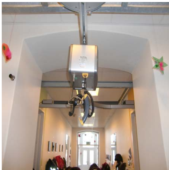
移動用クレーン・レーン
